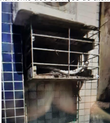
32.9. Condicionador de ar
