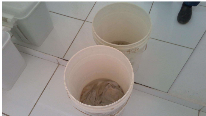
19.9. Balde para apagar a água do ar condicionado
