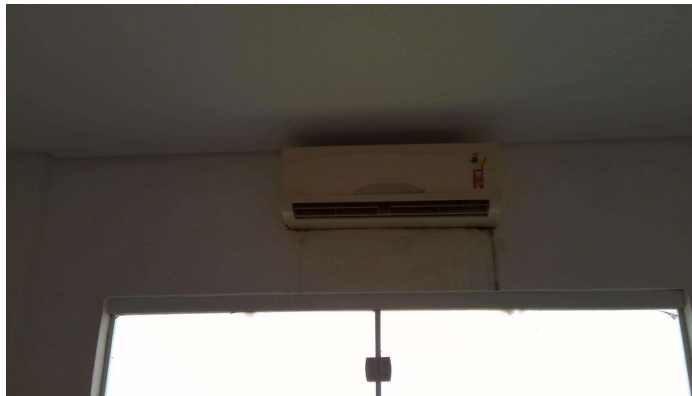
19.8. Ar condicionado pingando
