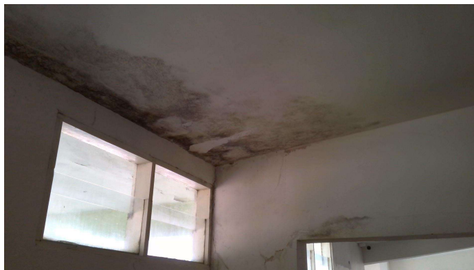
21.5. Infiltração no teto
