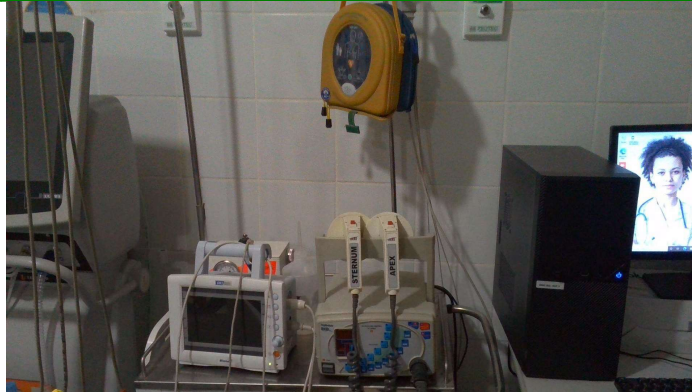
31.7. Equipamentos da sala vermelha
