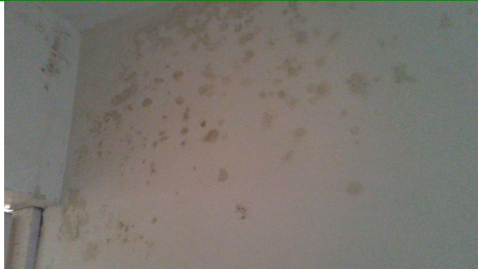
31.10. Paredes com infiltração e mofo
