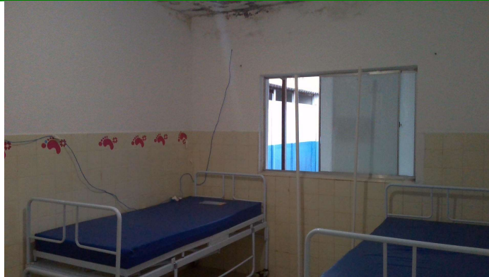
23.13. Leitos de observação covid (observar infiltração no teto)
