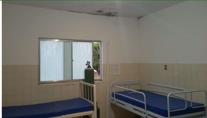
23.10. Observação adulto unissex (observar infiltração)
