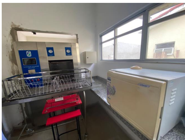
35.13. Esterilização II ( Autoclave sem funcionar, pois a rede elétrica não o suporta)
