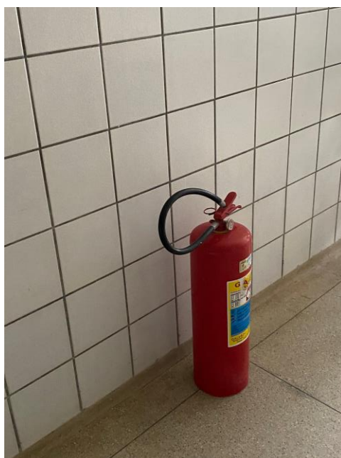
35.15. Extintor de Incêndio ( Tinham 3 em toda unidade)
