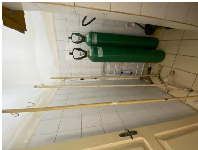
21.43. Oxigênio e suporte para soro. Torpedos sem fixação
