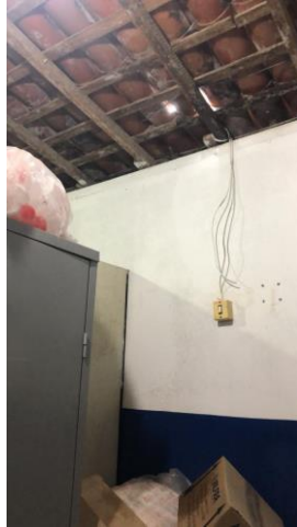
33.1. Instalações elétricas incompatíveis com a segurança do paciente
