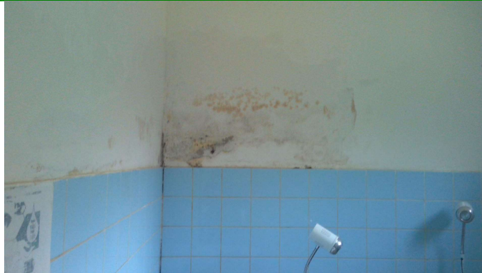
21.4. Infiltração na sala de curativo
