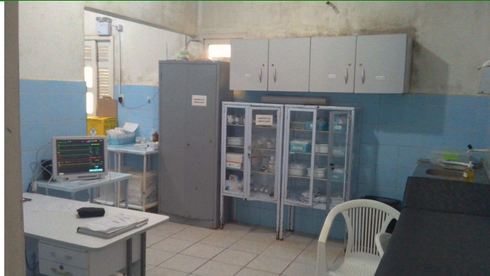
21.7. Posto de enfermagem (observar infiltração)
