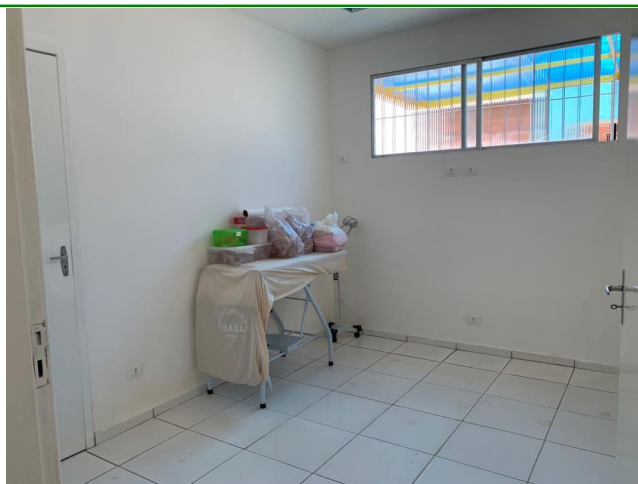
34.48. Sala sem funcionar
