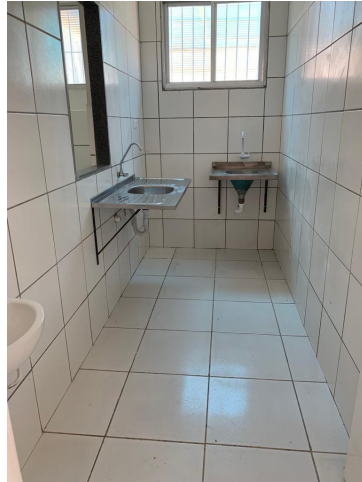
34.63. Expurgo sem funcionar
