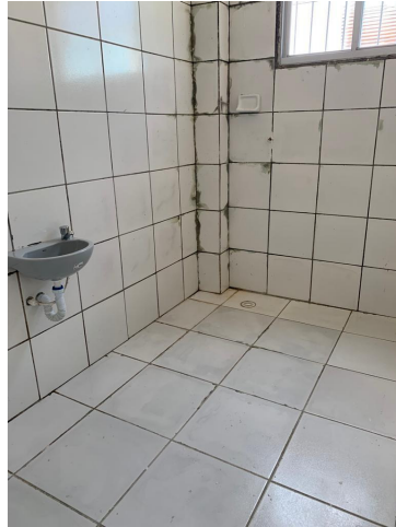
34.53. Sala sem funcionar
