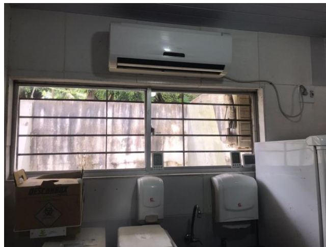
26.27. Sala de vacina climatizada
