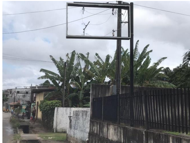
26.1. Ausência de placa de identificação
