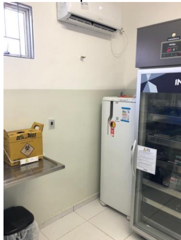
33.8. Sala de imunização / vacinação
