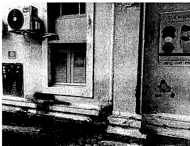
15.2. Área externa com infiltração
