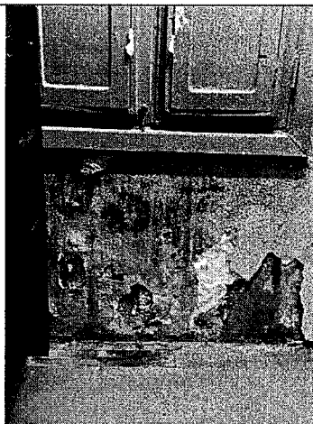
15.24. Infiltração na janela
