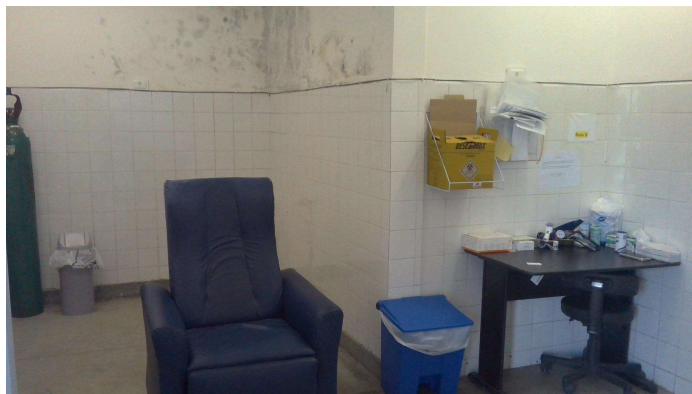
33.5. Sala de medicação setor covid (observar infiltração)
