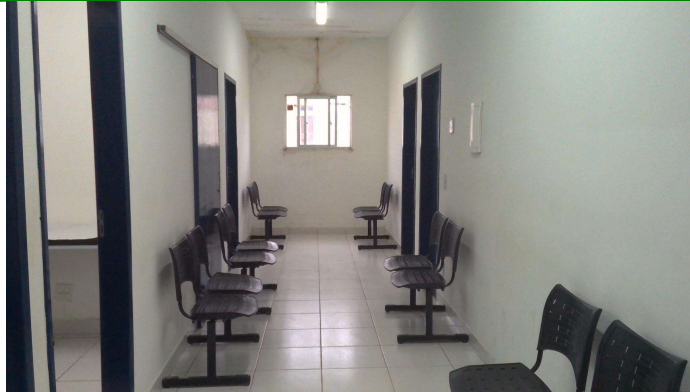
20.4. Corredor dos consultórios (observar infiltração na parede)
