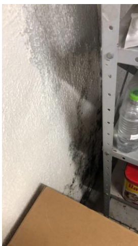
36.44. Infiltrações na parede da farmácia.
