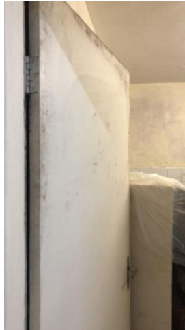
36.37. Sala antes usada para pré atendimento, com infiltrações e mofo
