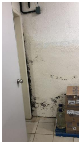
36.41. Farmácia com infiltrações
