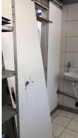
36.39. Esterilização sem separação entre SUJOS E LIMPOS
