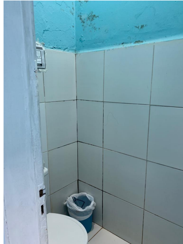
39.28. Banheiro Pac Mofo
