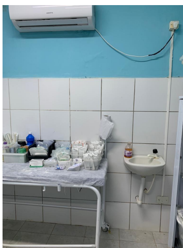
39.36. Sala Vermelha Pia sem dispensador de sabão liq e sem papel toalha
