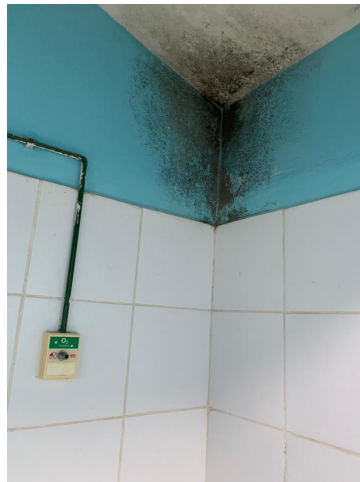
39.72. Corredor Interno Mofo
