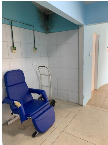
39.71. Corredor Interno Mofo
