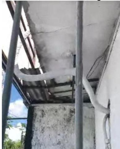
24.5. Lateral externa com infiltração e mofo
