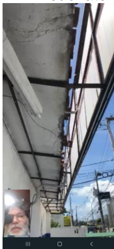
24.3. Laje com infiltrações
