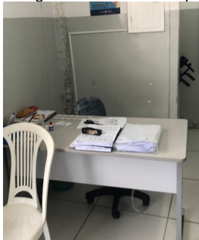
24.24. Infiltrações em paredes internas
