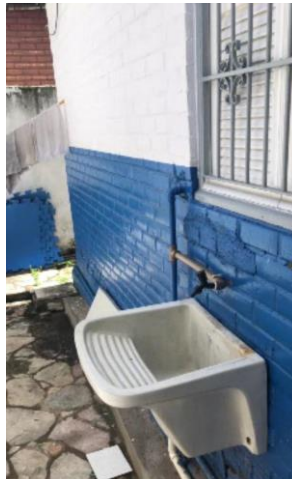
24.8. Tanque usado para higienizações
