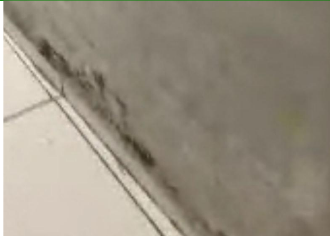
24.25. Infiltrações em paredes internas
