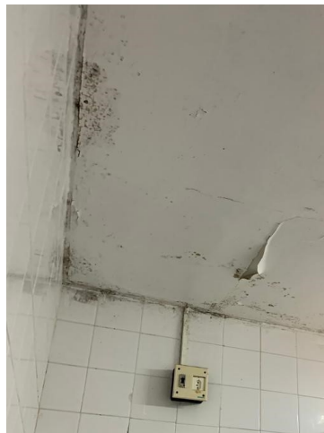
18.51. Banheiro gestantes infiltração e mofo
