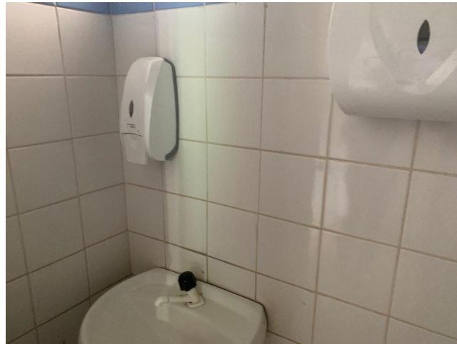
30.16. Banheiro Recepção Sem papel toalha
