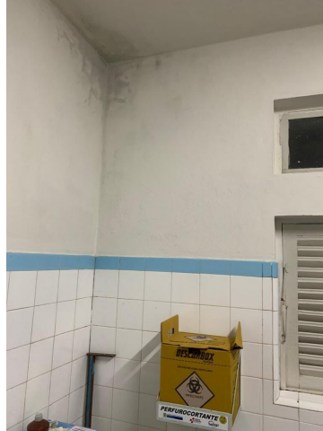
30.58. Sala Parto sinais infiltração e mofo
