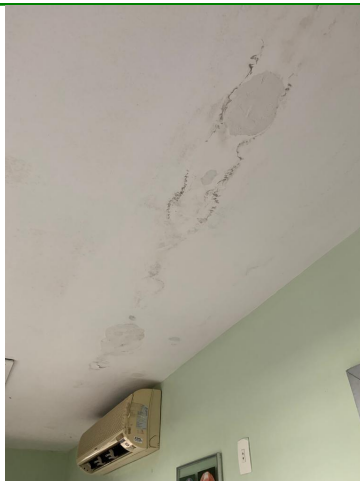
29.38. Sinais de Infiltr Mofo e Split
