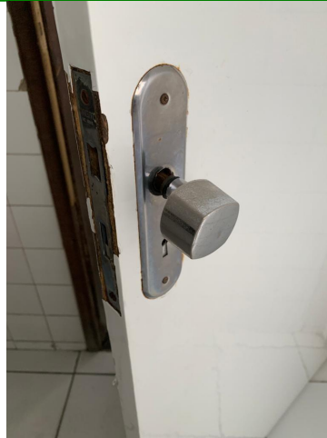
29.8. Recepção Banheiro Maçaneta quebrada
