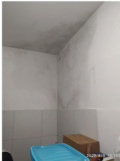
29.8. Infiltração e Mofo em teto e paredes
