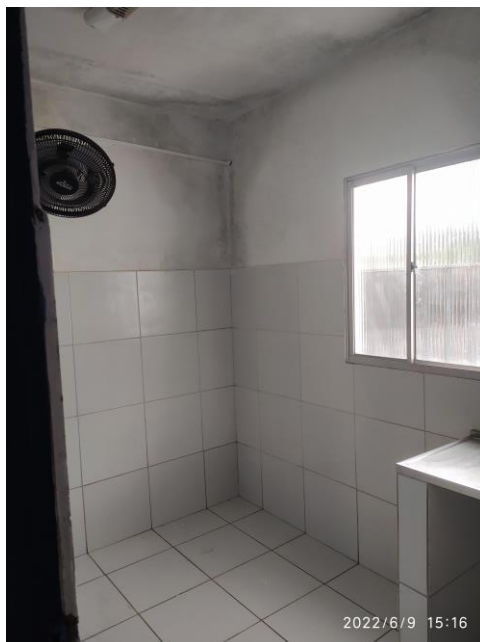
29.10. Sala sem uso, com infiltrações e mofo
