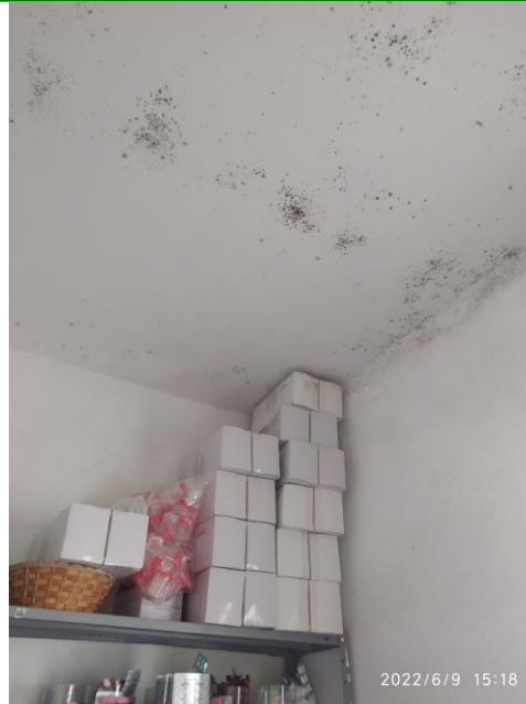
29.13. Mais infiltração e mofo
