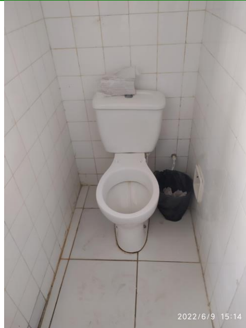
29.5. Banheiro de funcionários sem aeração e com vaso sem tampa
