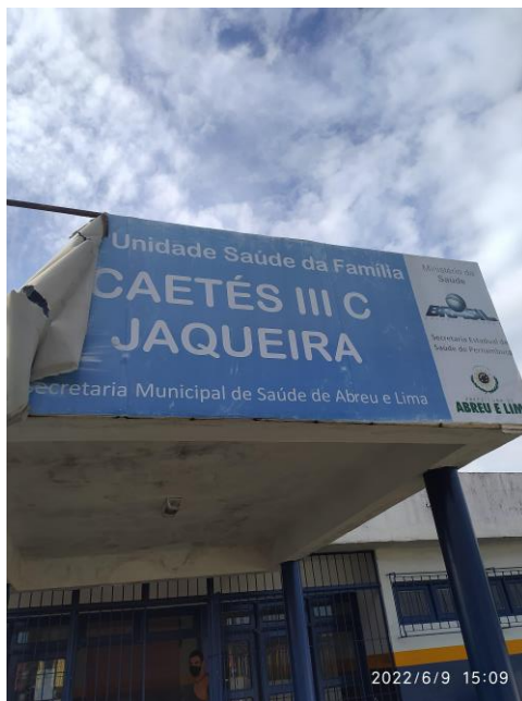
29.1. Placa Externa Caindo
