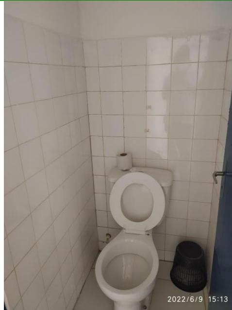
29.3. Banheiro para usuários sem ventilação e sem pia
