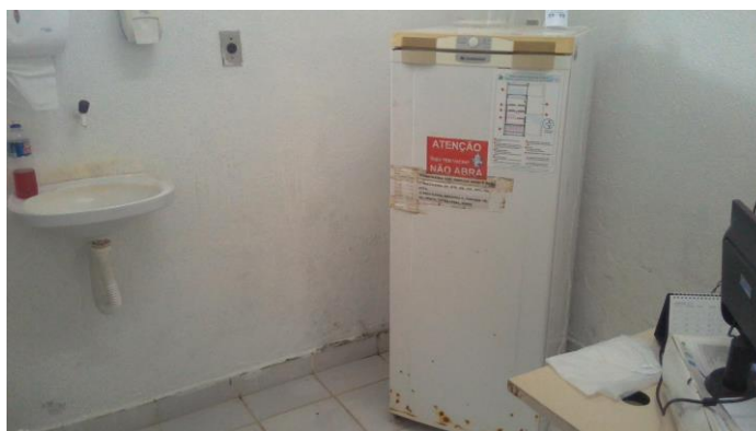
30.14. Sala de imunização / vacinação
