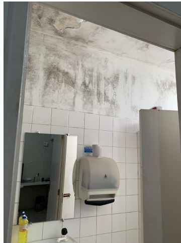
31.76. Rep Med Banheiro Mofo
