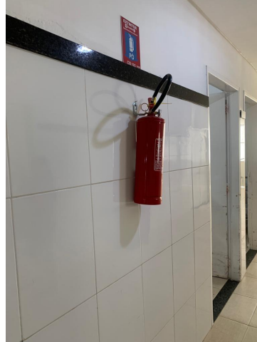
31.38. Extintor de Incendio
