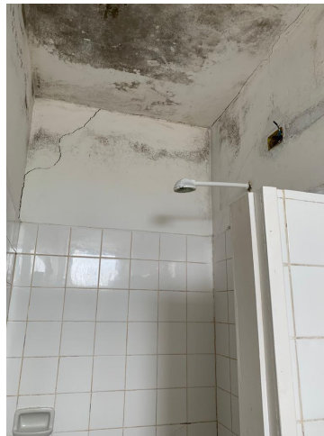
31.77. Rep Med Banheiro Mofo
