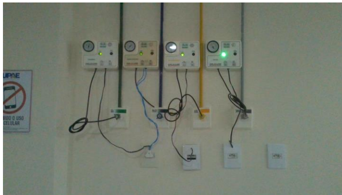
41.11. Alarme de gases
