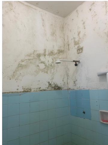
30.36. Posto Enf Banheiro Mofo
