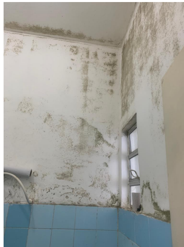
30.37. Posto Enf Banheiro Mofo
