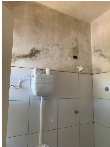
30.46. Sala Verm Banheiro Mofo
