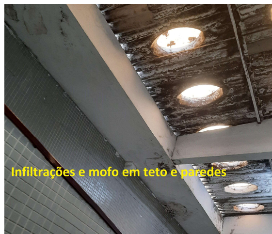
25. Infiltrações e mofo em teto e paredes
