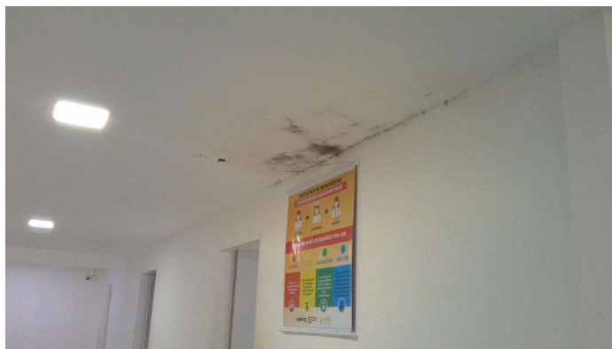
23.18. Infiltração no teto
