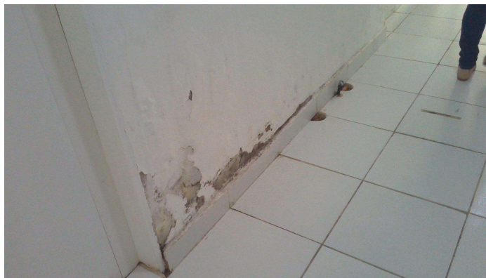
23.14. Parede com reboco caindo
