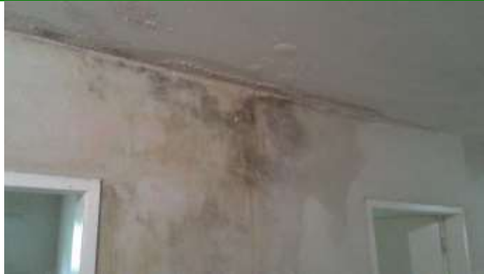
34.14. Infiltrações e mofo
