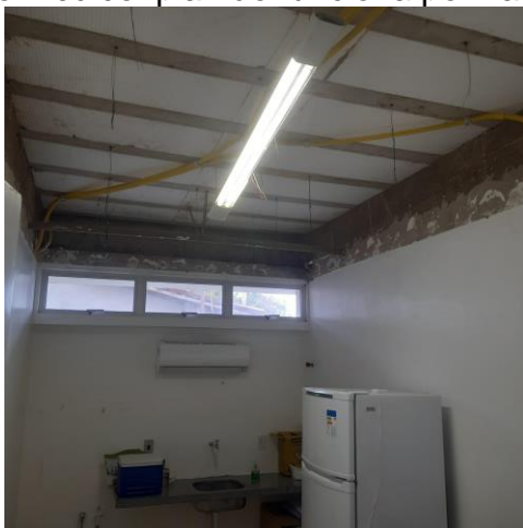
30.8. Sala de vacinação sem forro no teto
