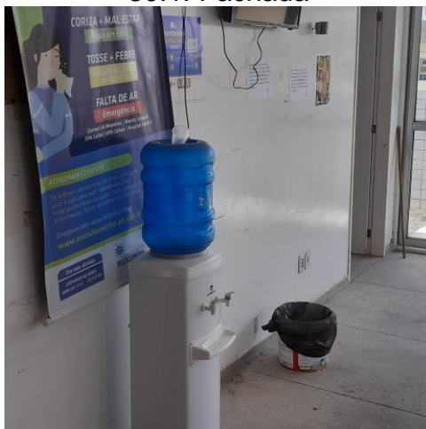
30.2. Sala de Espera com lixeira sem tampa e sem climatização
