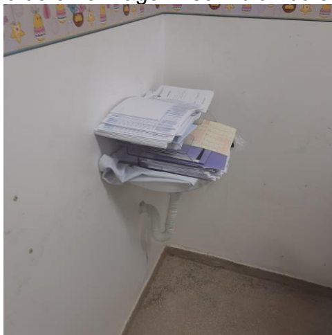
30.11. Consultório de enfermagem: pia sem funcionar
