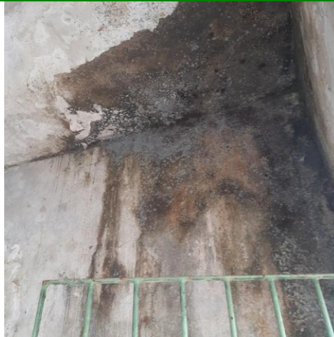
30.7. Infiltrações e mofo na sala de espera em teto e parede
