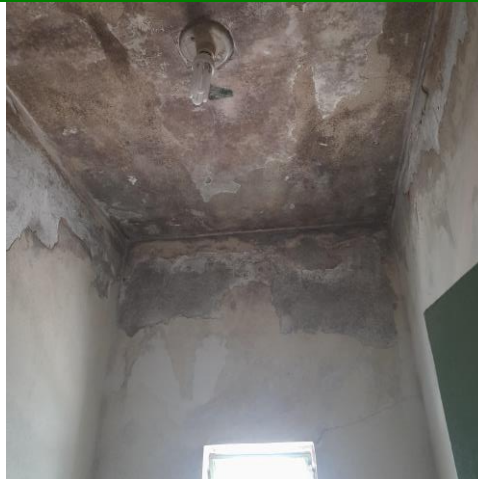
30.13. Infiltrações e mofo no banheiro dos funcionários
