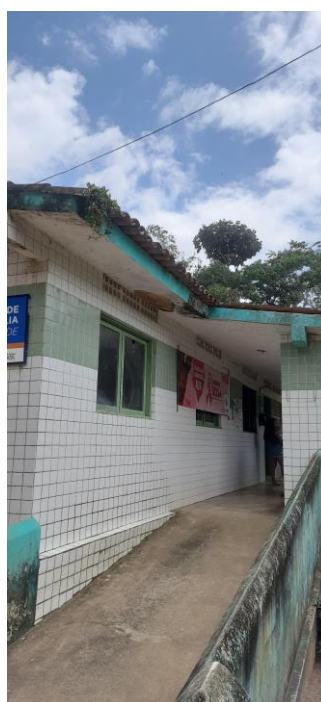
31.2. Acesso por rampa. No teto se verificam infiltrações
