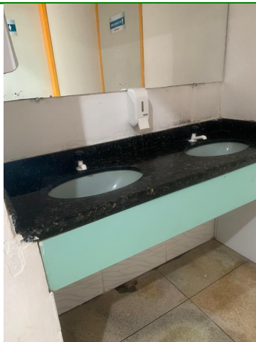
31.13. Recepção Pias Banheiros
