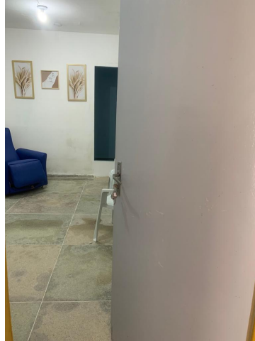
31.66. Bloco Cirurgico Sem sinalização
