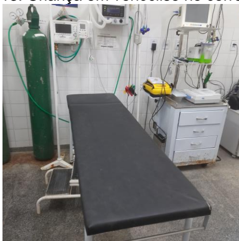
24.14. Sala vermelha com cilindros de Oxigênio sem fixação
