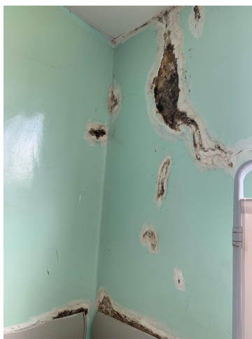
40.76. Sinais de Infiltração e mofo
