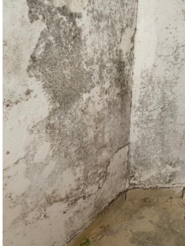
40.93. Infiltração e mofo
