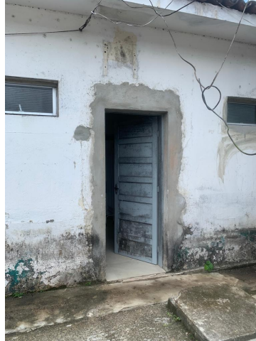
33.28. Sala Verm Area Ext Mofo Fiação Exposta
