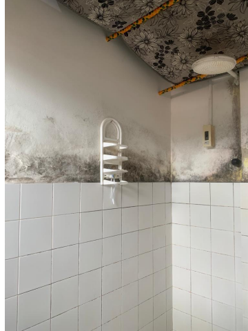
33.88. Banheiro Corredor Colchões Teto Mofo
