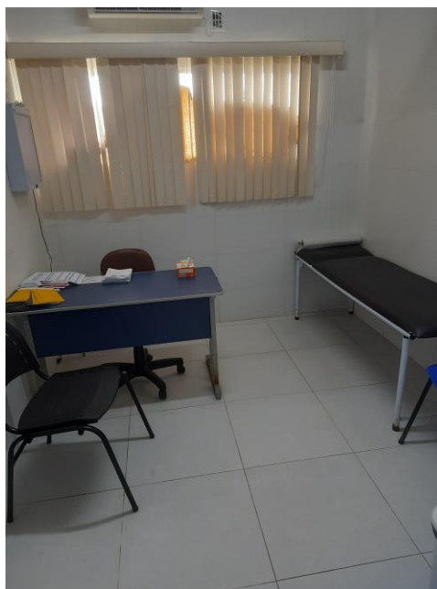
25.2. Consultório. Observe a ausência de pia e de escadinha de 02 degraus
