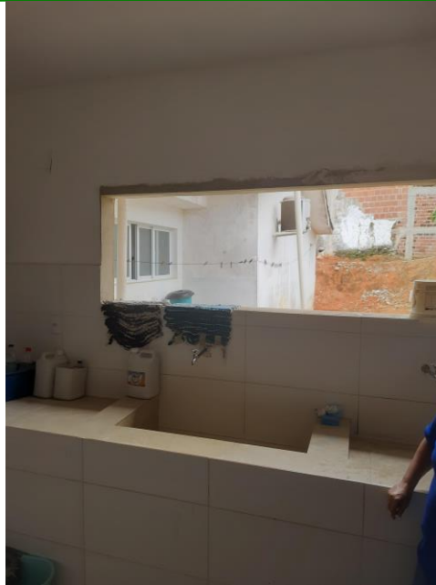
25.22. Lavanderia com tanques e sem tela nas janelas. Roupas secam em varal.
