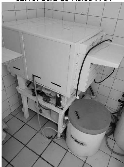
32.14. Sala de Raios-X 02: revelador
