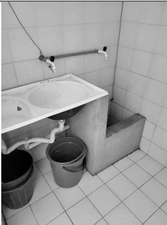
32.21. Local para higienização de estopas e materiais de limpeza: funcionárias sem EPI e tanque doméstico com cuba rasa
