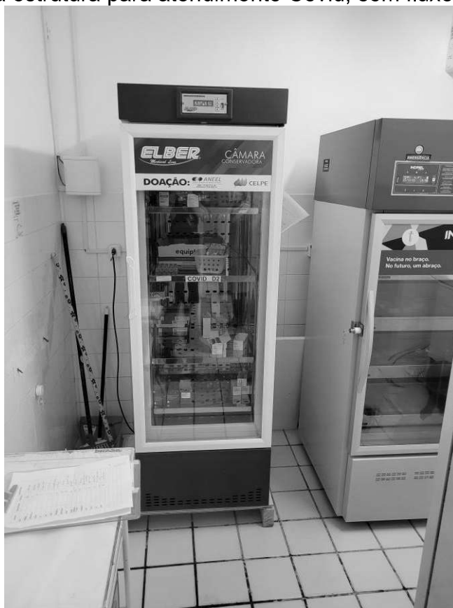
32.12. Câmaras frias para guarda de vacinas
