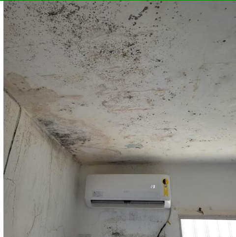
32.5. Consultório Médico com Infiltrações e Mofo
