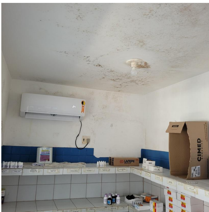
32.4. Farmácia com infiltrações e mofo
