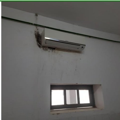
29.24. Ar condicionado com infiltração na sala de gesso/ consultório de ortopedia
