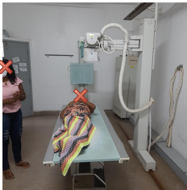
29.27. Sala para Raios-X equipada, com funcionário utilizando dosímetro
