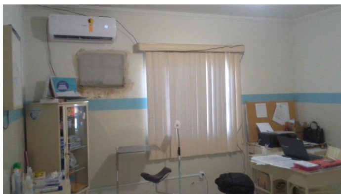
32.5. Sala de atendimento de enfermagem
