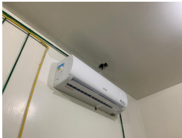
43.32. CC Sala A Split Buraco Teto
