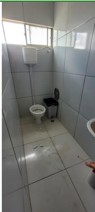
28.11. Banheiro para pacientes próximo à Observação, com lixeira e vaso sanitário sem tampas
