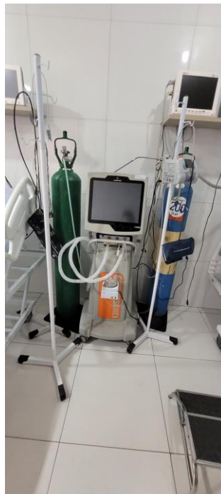
28.16. Torpedo de Oxigênio sem fixação na Sala Vermelha
