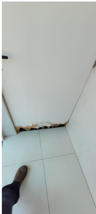
28.4. Porta do banheiro dos usuários com rodapé danificado
