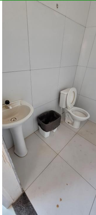
28.5. Banheiro dos usuários na emergência: lixeira sem tampa
