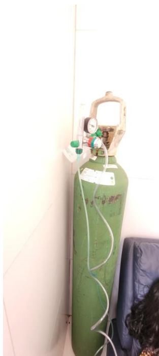
28.10. Cilindro de Oxigênio na Sala de Observação sem fixação
