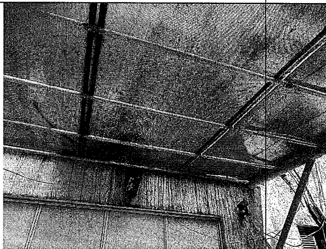
32.3. Area Externa Mofo Fiação
