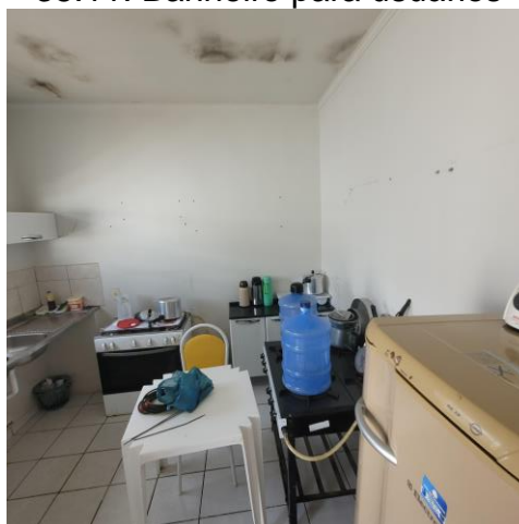
35.12. Cozinha doméstica: infiltrações no teto e botijão de gás no meio da copa
