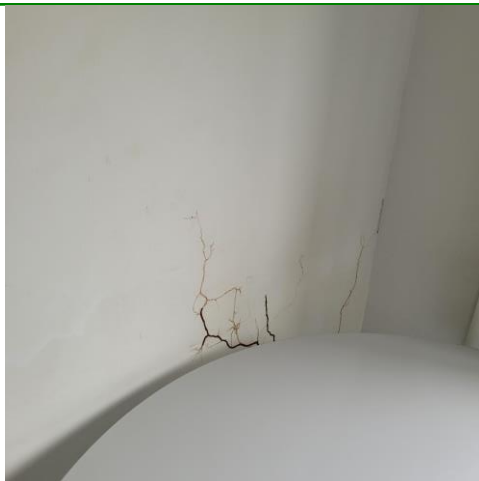
35.4. Parede com infiltração e mofo
