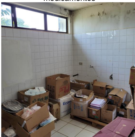
31.21. Descartáveis mal acondicionados com algumas caixas no chão
