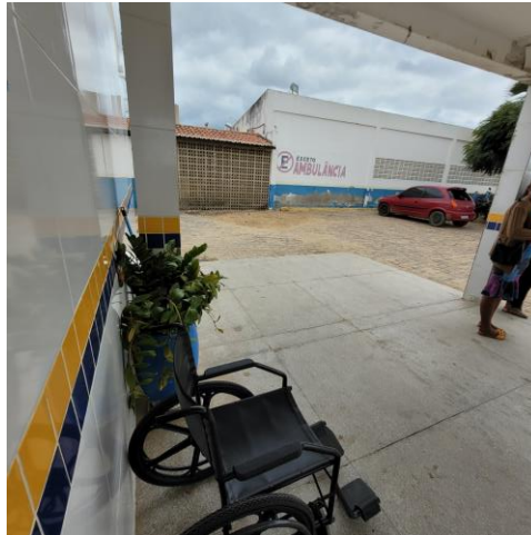
31.1. Acesso para ambulância é coberto, mas o teto estava com infiltrações e mofo
