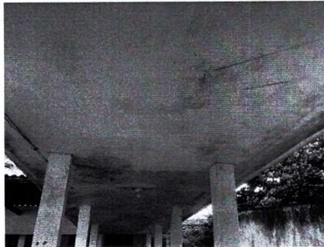
32.67. Corredor Interno Mofo
