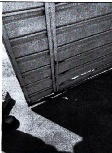
30.8. Portao Entrada Quebrado
