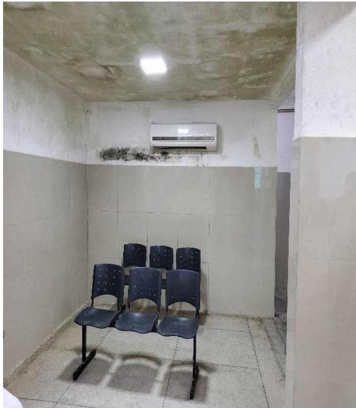
Sala de espera (observar infiltração)
