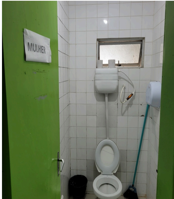
Alguns materiais de limpeza como vassouras são guardados nos banheiros, denotando a falta de um depósito de material de limpeza - DML
