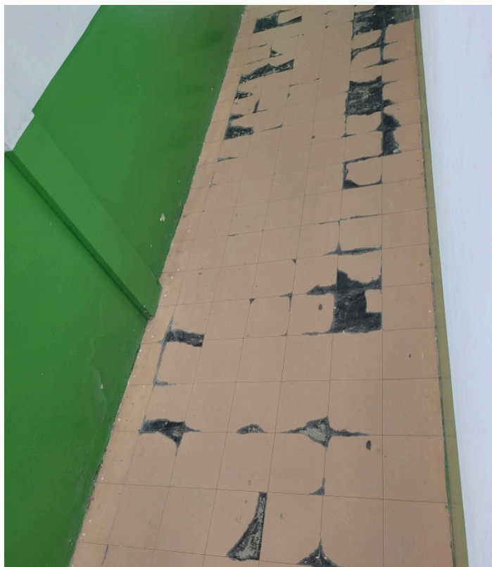
Piso desgastado em algumas áreas de circulação da unidade
