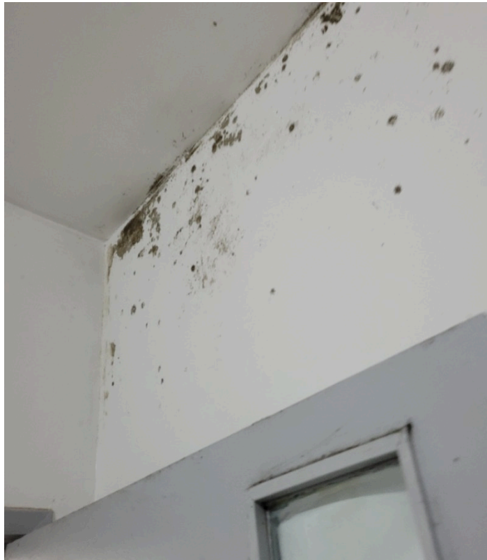
Outra área de infiltrações e mofo
