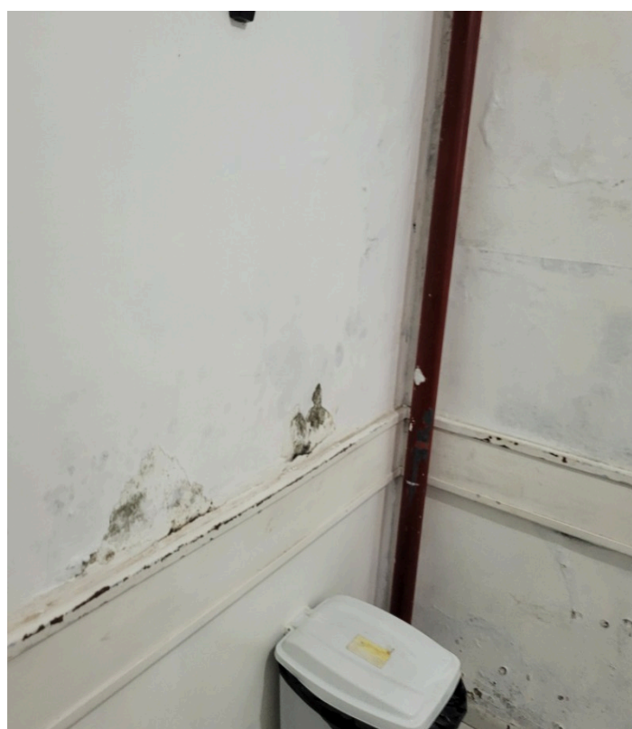
Há infiltrações e mofo em paredes e áreas de circulação da unidade
